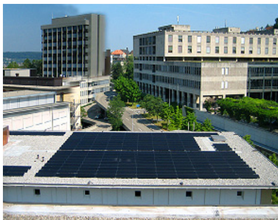
Figure 8 Vue partielle de l'installation de l'EPFZ: modules intégrés en toiture plate (Source: Energiebüro)
